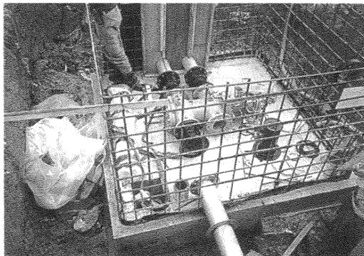
写真8 緊急遮断弁設置状況
