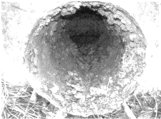
写真1 内面腐食状況(鋼管φ250)
