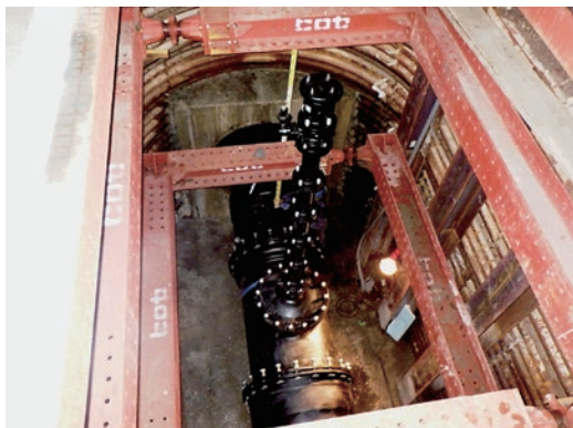
写真3 立坑内の配管状況
