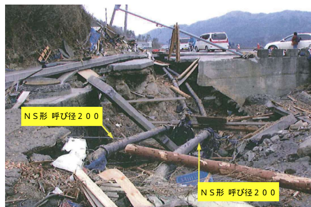
図3 津波による道路崩壊に耐えた耐震管路
