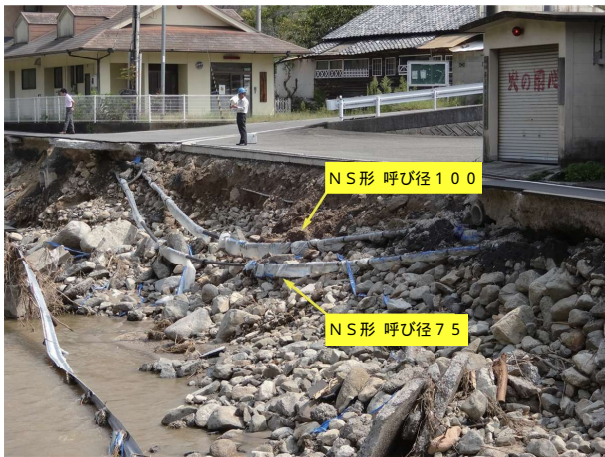
図4 豪雨による道路崩壊に耐えた耐震管路
