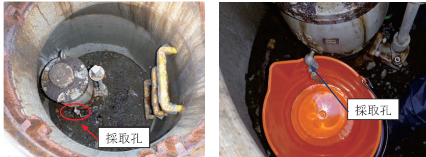
写真1 空気弁の採取孔設置状況の例
