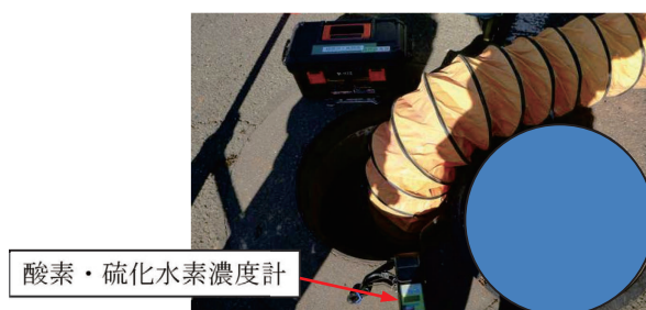
写真8 空気弁室での酸素・硫化水素濃度測定及び換気作業の一例
