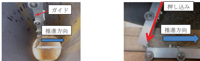
写真4 逆方向屈曲状況
