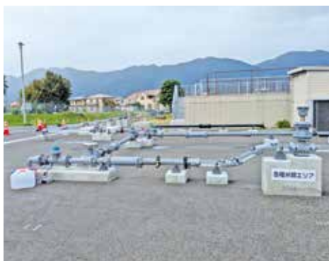
研修設備（地上配管部）
