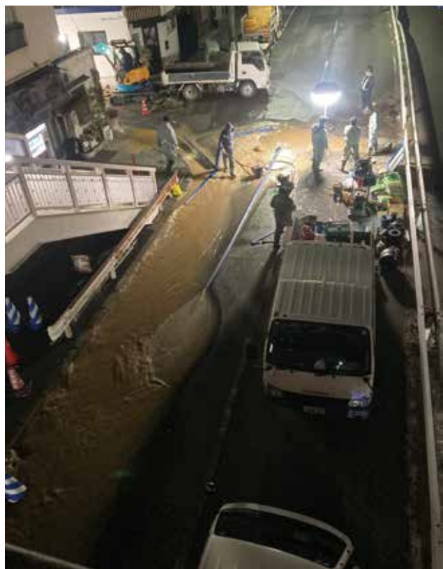
水道管漏水現場状況
