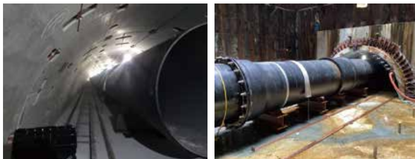
写真2 トンネル内配管
