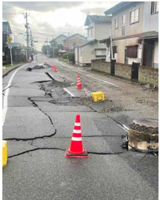
宝立町 道路破損状況
