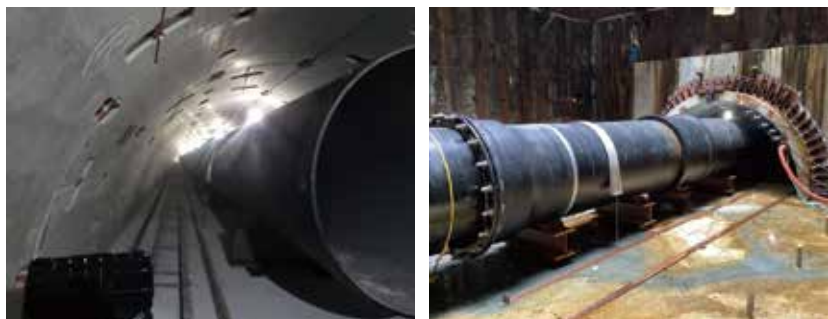
写真2 トンネル内配管
