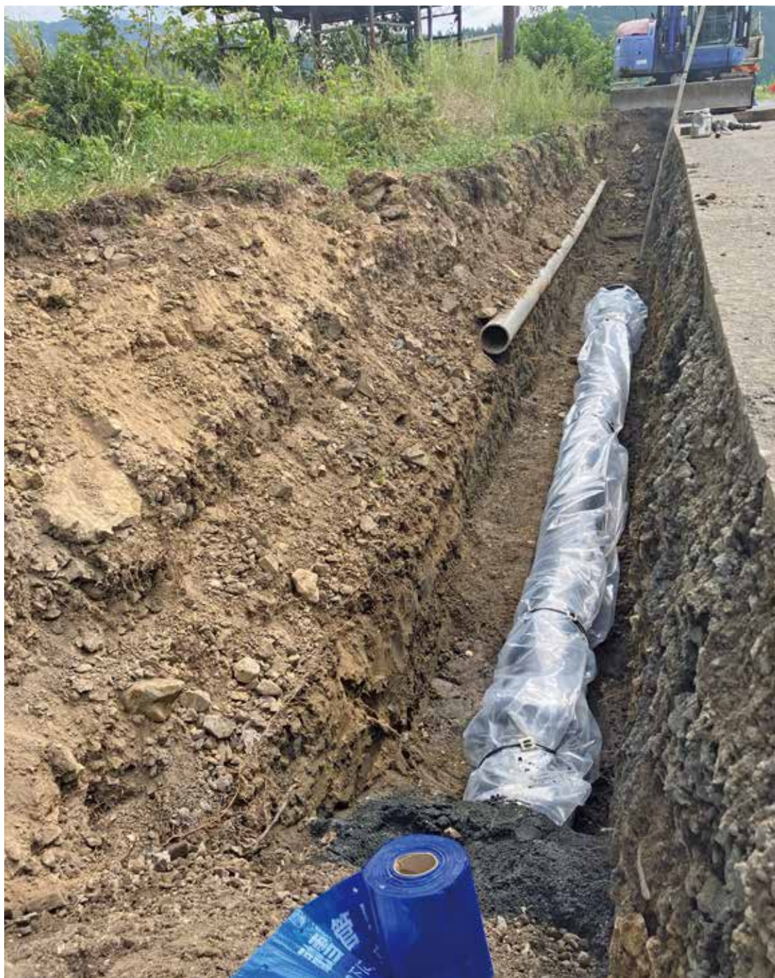
滋賀県長浜土木事務所 木之本支所 K 形 呼び径 200
