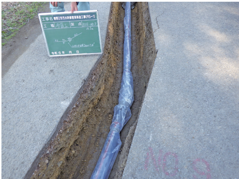
高知市上下水道局 GX 形 呼び径 100 (汚水圧送管)
