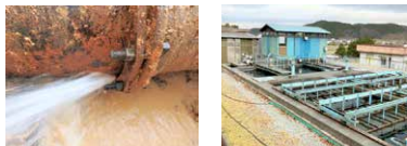
老朽化した水道管と浄水施設の写真
