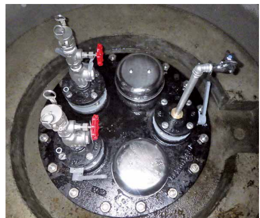
写真8 弁室内給水設備
