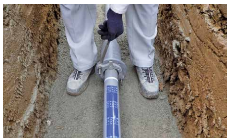
写真5 S50形配管状況④
