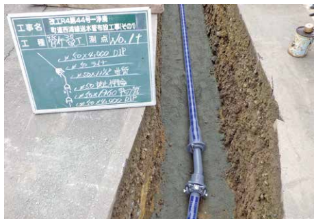
写真2 S50形配管状況①
