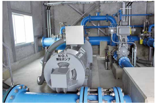
写真10 南石関ポンプ場の内部 ・主要設備 ポンプ設備2台 ・ポンプ規格 揚水量7.0m 3 /分 ×揚程130m
