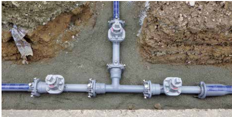
写真3 S50形配管状況②
