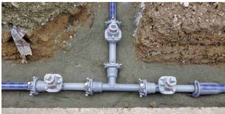
写真3 S50形配管状況②
