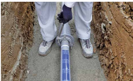
写真5 S50形配管状況④
