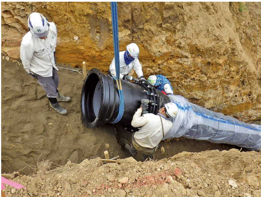
いわき市水道局 (福島県) NS形 呼び径 700
