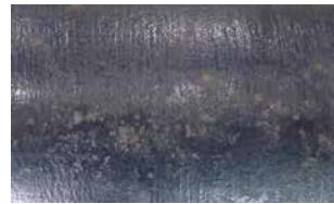
写真4 ポリエチレンスリーブなしの外面状況
