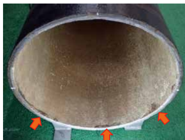
管端部で僅かに剥離した箇所あり
