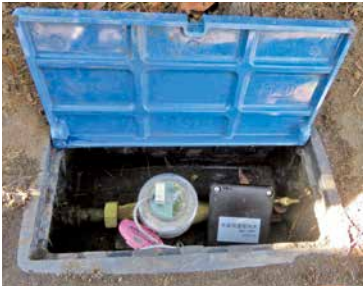
公共施設実験箇所設置写真(機器接写)
