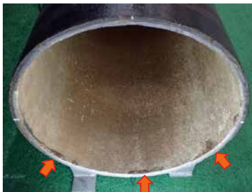
管端部で僅かに剥離した箇所あり
