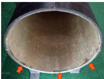
管端部で僅かに剥離した箇所あり
