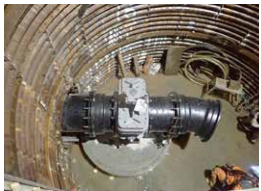
写真15 No.2 中間立坑部配管状況
