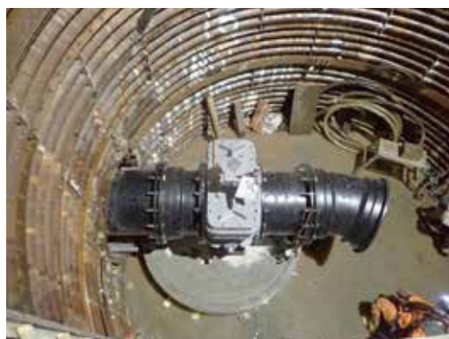
写真15 No.2 中間立坑部配管状況
