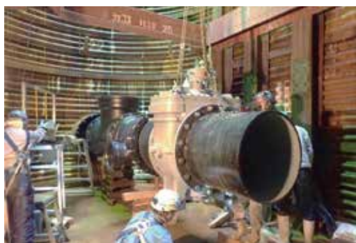
写真16 No.3 中間立坑部配管状況
