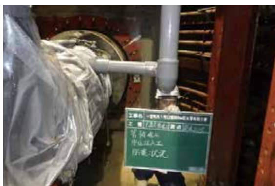
写真 17 中込充填閉塞状況
