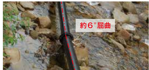
写真 3 許容曲げ角度を超過した継手
