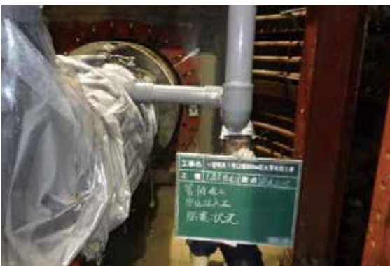
写真 17 中込充填閉塞状況
