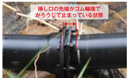
写真 4 許容胴付間隔を超過した継手
