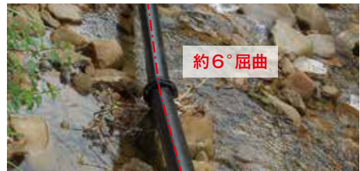
写真 3 許容曲げ角度を超過した継手
