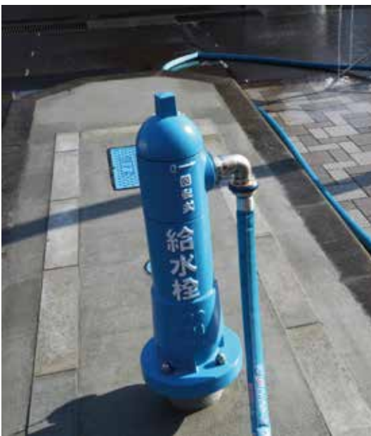
災害時給水栓（提供：仙台市）
