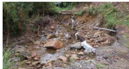
写真2 被害状況(令和2年8月28日撮影)
