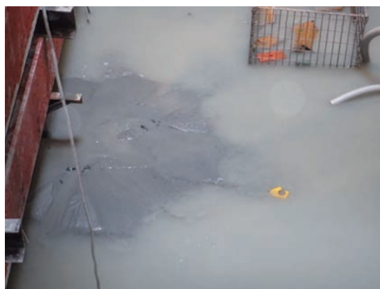
写真4 7段目湧水発生状況
