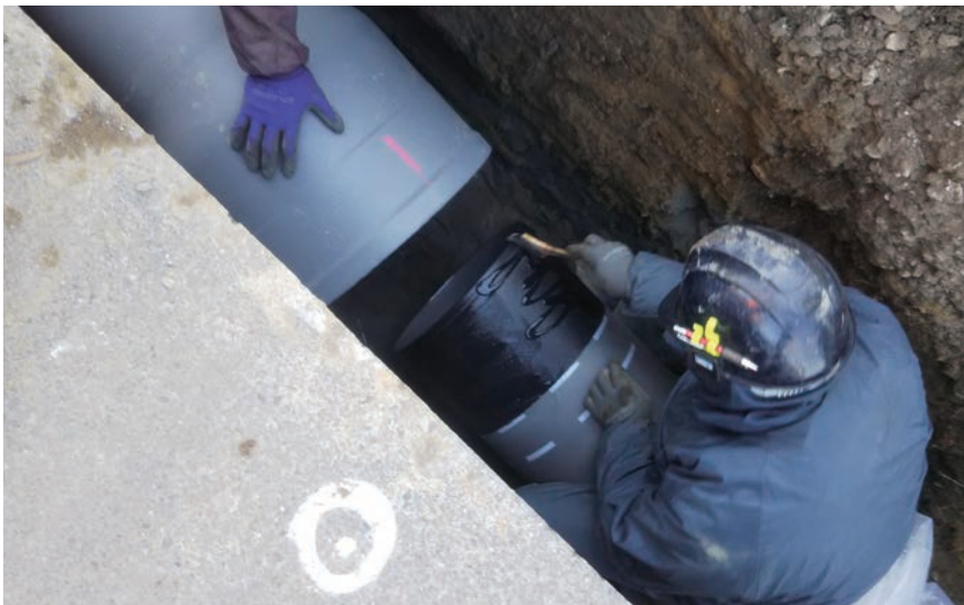
取手地方広域下水道組合（茨城県） GX形 呼び径 350
