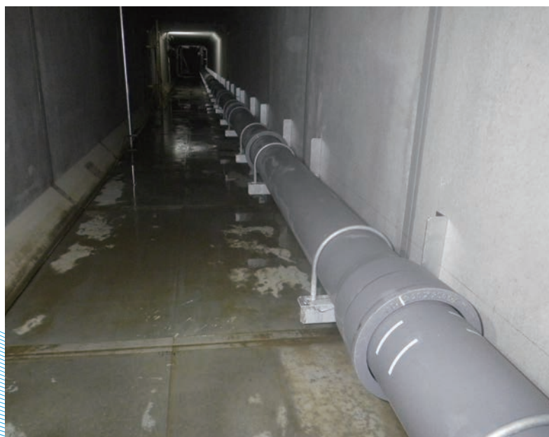
中日本高速道路株式会社 (新東名高速道路 羽根トンネル) GX形 呼び径 250
