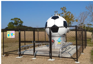
貯水機能付給水管
