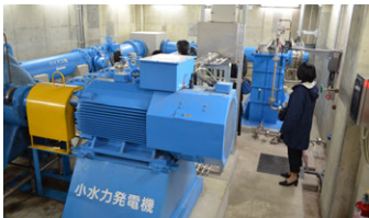
松原浄水場内にある小水力発電施設
