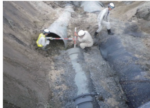
図8 曲管部の移動に伴う管の離脱
