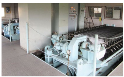
えのくま浄水場脱水機
