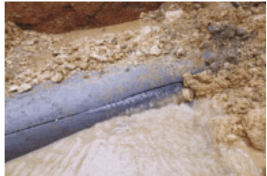
(b) 管体破損の状況
