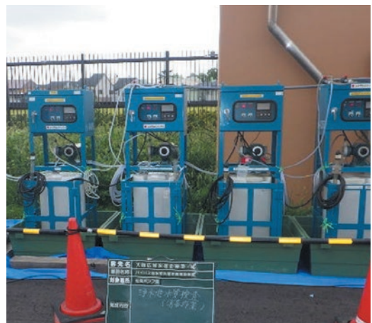
写真4 次亜塩素酸注入装置
