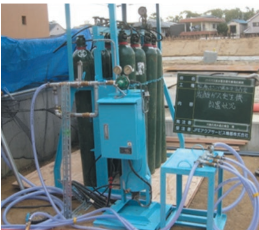
写真3 炭酸ガス注入装置
