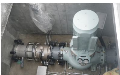
三芳配水場小水力発電設備
