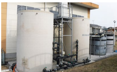
汚泥減容化プラント
