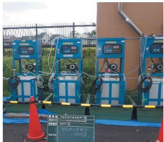
写真4 次亜塩素酸注入装置
