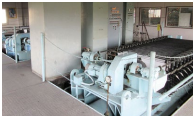
えのくま浄水場脱水機
