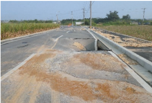
(a) 道路陥没の状況
