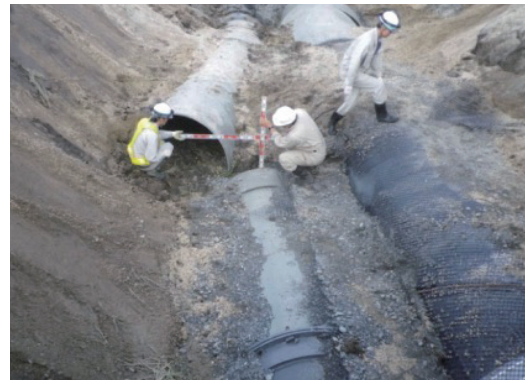
図8 曲管部の移動に伴う管の離脱
