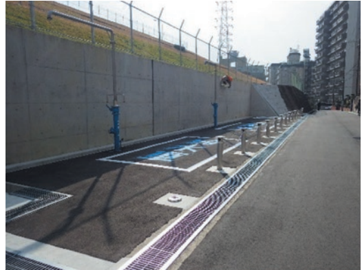
写真1 応急給水栓(寺内配水池)
