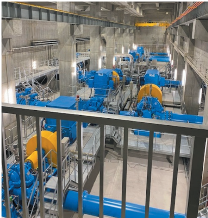
写真5 松原ポンプ場ポンプ設備
