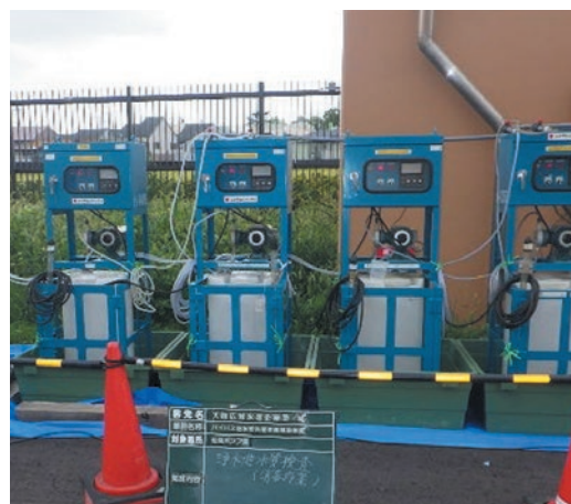
写真4 次亜塩素酸注入装置
