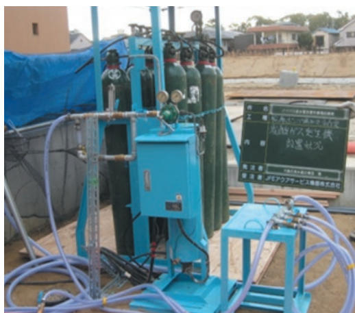
写真3 炭酸ガス注入装置
