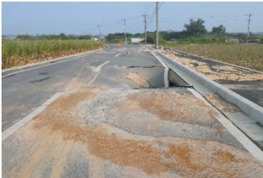
(a) 道路陥没の状況
