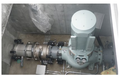
三芳配水場小水力発電設備
