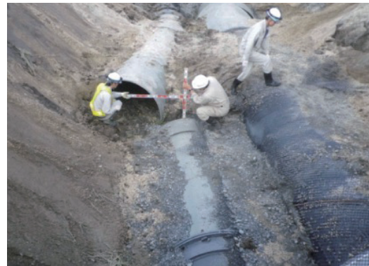
図8 曲管部の移動に伴う管の離脱
