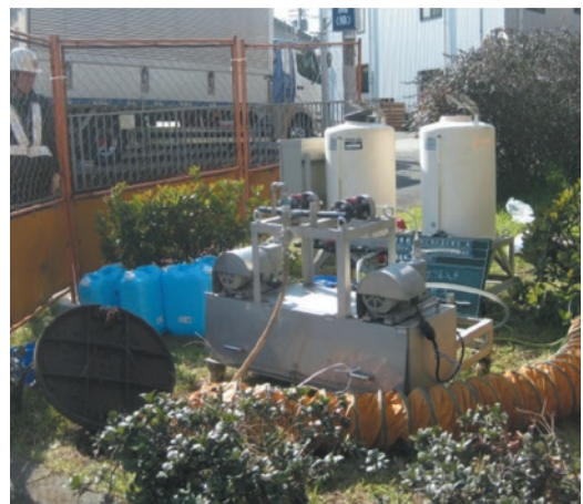
写真2 チオ硫酸ナトリウム水溶液注入装置
