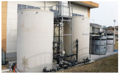
汚泥減容化プラント
