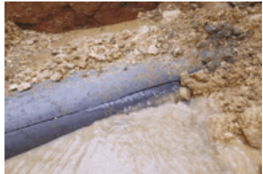
(b) 管体破損の状況
