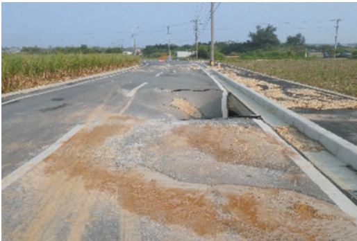
(a) 道路陥没の状況
