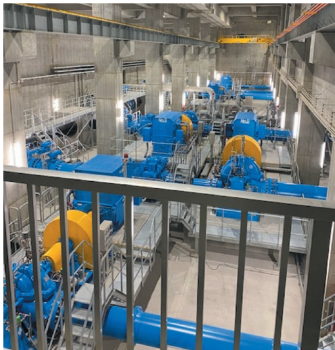
写真5 松原ポンプ場ポンプ設備
