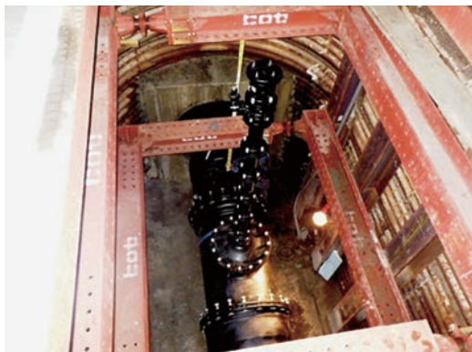
写真3 立坑内の配管状況
