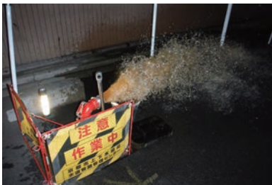
消火栓からの放水
