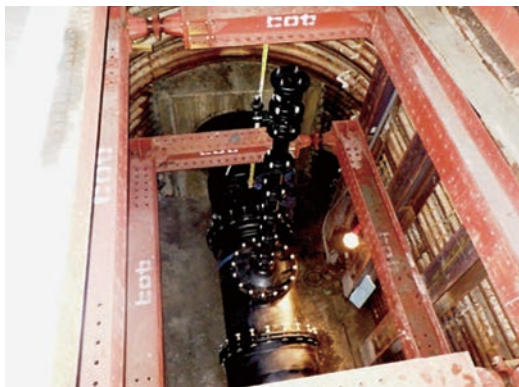
写真3 立坑内の配管状況
