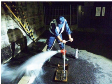
消火栓からの放水
