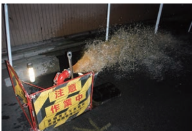
消火栓からの放水
