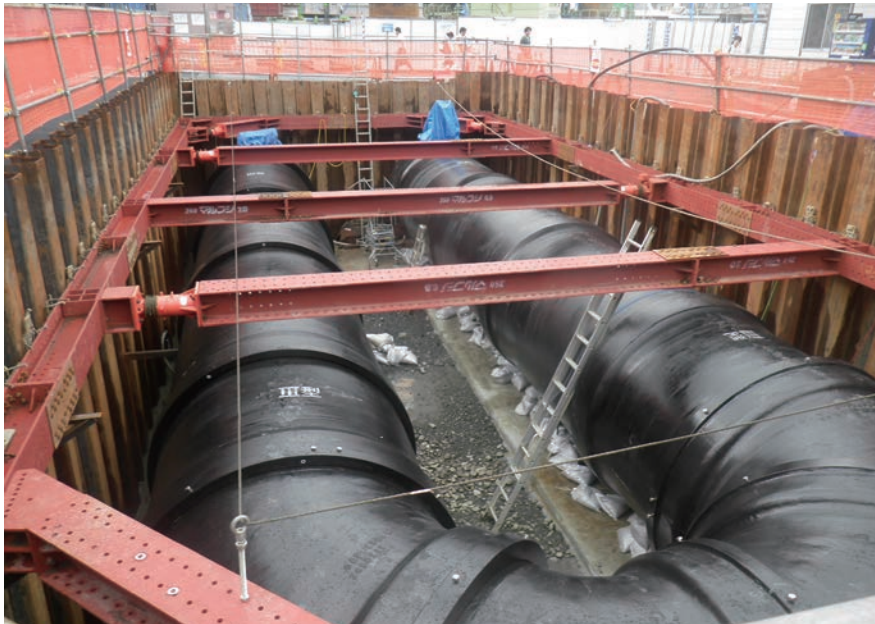
順天堂大学医学部附属静岡病院 LUF形 呼び径 2600 耐震貯水槽 (200m 3 )
