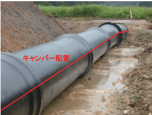
写真1 キャンバー配管の状況
