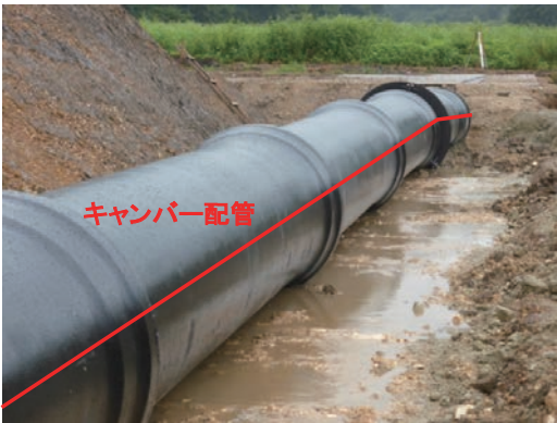
写真1 キャンバー配管の状況
