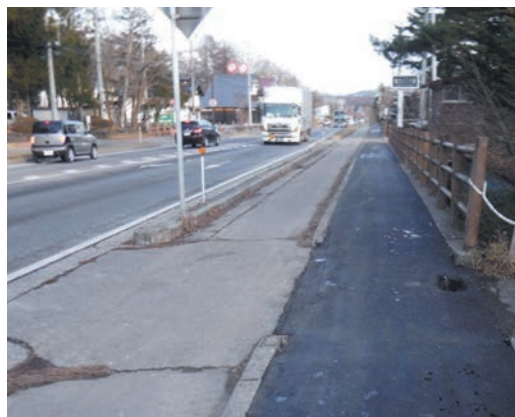
写真4 施工現場の全景 シーズン中は、車道・歩道とも交通量が多い
