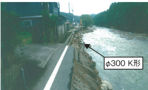
写真2 管路被害状況 (φ300 K形)
