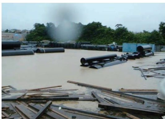
平成21年7月豪雨で被害を受けた乙金浄水場
