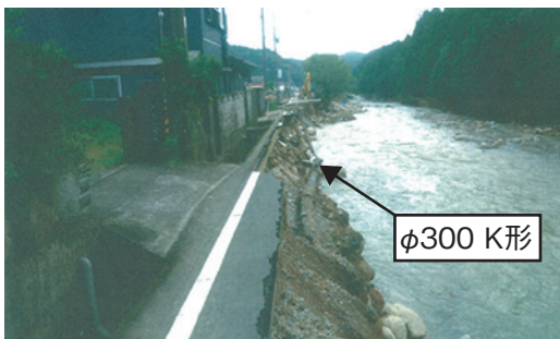
写真2 管路被害状況(φ300 K形)
