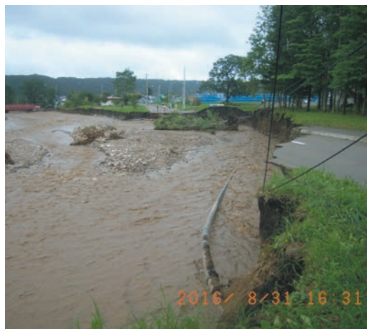
写真4 呼び径200硬質塩化ビニル管流失状況
