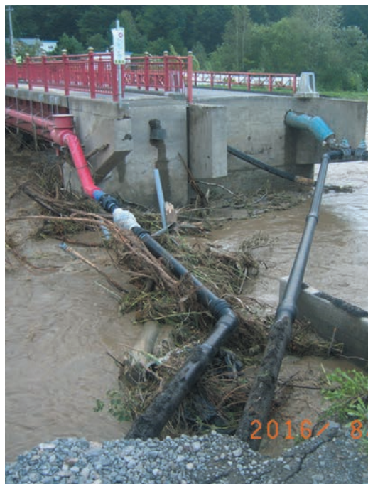
写真7 道路が流されても耐える 呼び径200 NS形ダクトイル鉄管①
