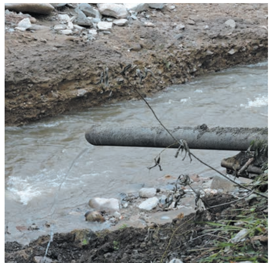
写真2 呼び径200 A形継手離脱状況
