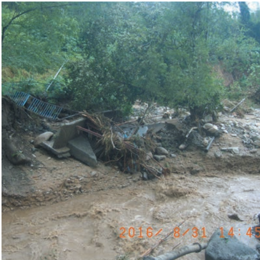
写真1 取水場の損壊状況
