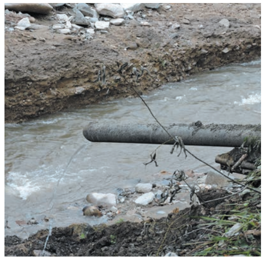
写真2 呼び径200 A形継手離脱状況
