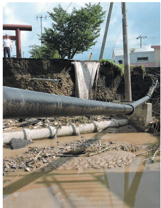
写真8 道路が流されても耐える 呼び径200 NS形ダクタイル鉄管②
