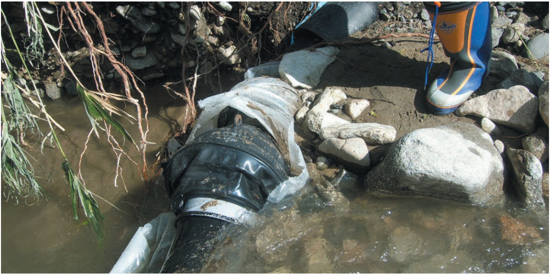
写真3 呼び径200 NS形継手の状況
