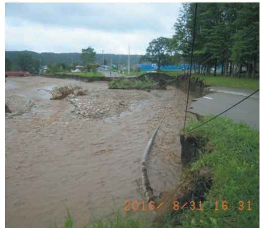
写真4 呼び径200硬質塩化ビニル管流失状況
