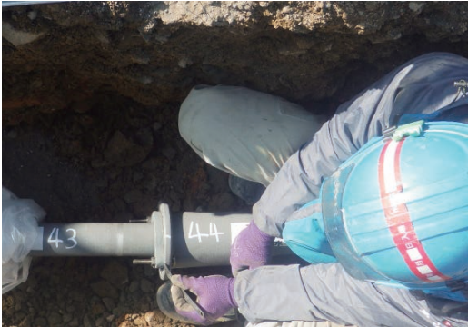
写真4 メタルタッチ確認状況
