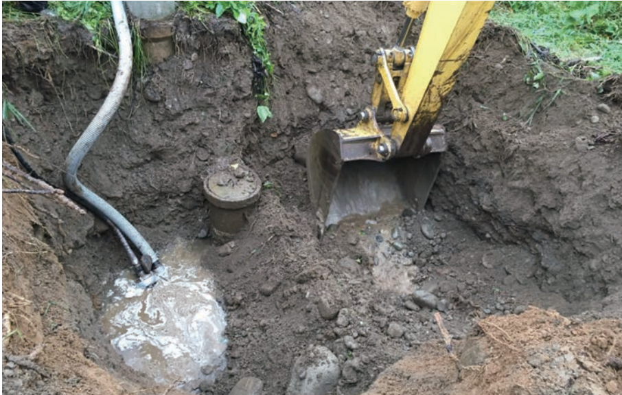
写真1 漏水事故への対応
