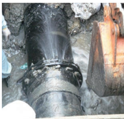
写真 1 漏水した管路 (A 形鉄管 継手漏水)
