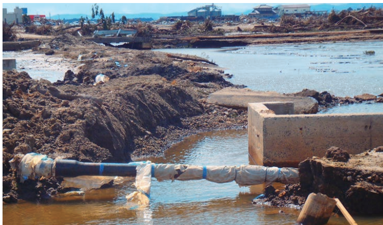
津波の洗掘にも耐えた NS 形呼び径 150
